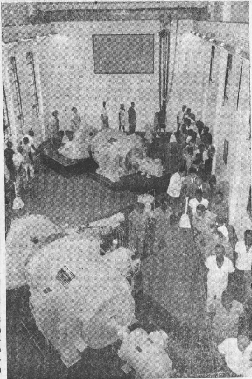
Um aspecto do conjunto das máquinas da nova central de aproveitamento hidroeléctrico do rio Contador.
